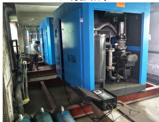
2 台 55kW 永磁電機及變頻功能的節能螺桿空氣壓縮機
