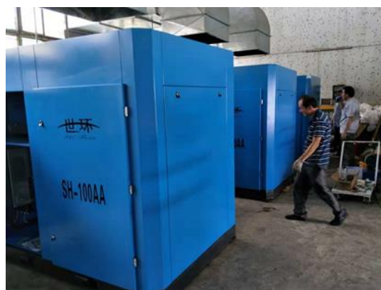
3 台 75kW 永磁電機及變頻功能的節能螺桿空氣壓縮機
